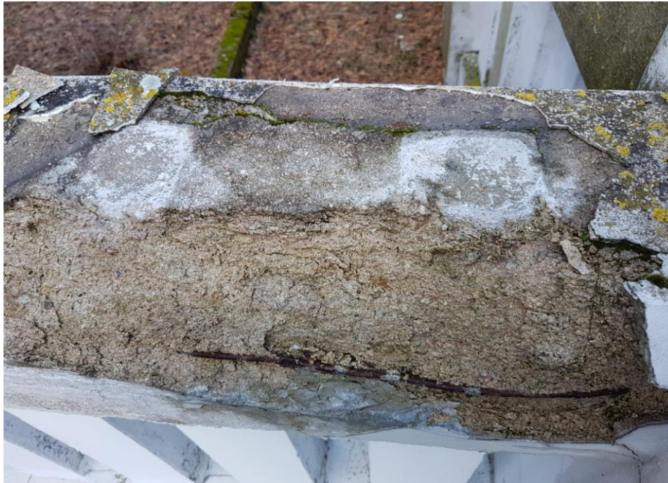
Fot.12 Ubytki w belce poręczowej, widoczne zbrojenie podłużne średnicy 6mm.
